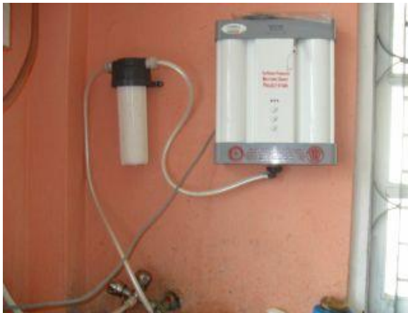
Bild på vattenreningsapparaten och när den installerades.
